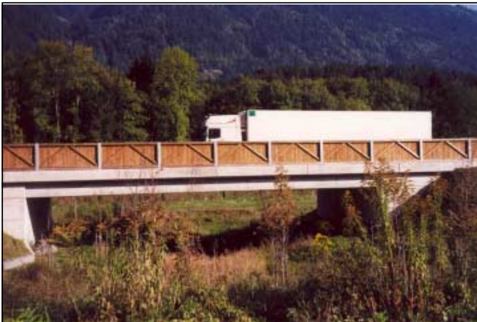
Wildquerungshilfe unter der B 100 im Drautal – Höhe für Rotwild fast zu gering
